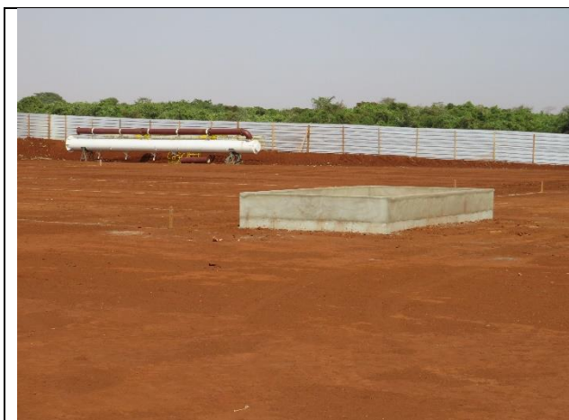
Autor: AMAE/RIO VERDE Descrição: Estrutura para o gerador, na ETE Laje.
